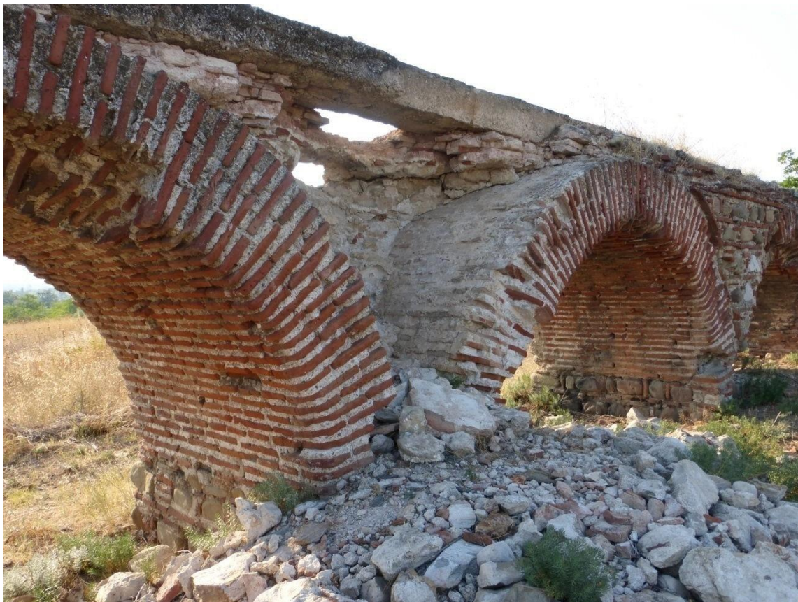
Слика 9: Оштетување на циглите на врвот на Аквадуктот и помеѓу сводовите, предизвикано од мрзнење
